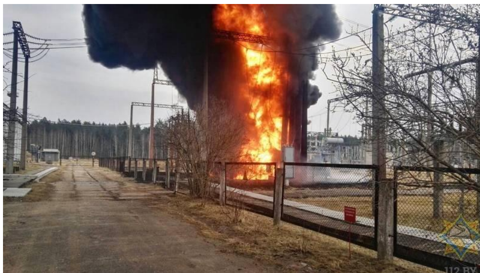
Рисунок 2. Возгорание трансформатора под воздействием электрической дуги внутри бака трансформатора
